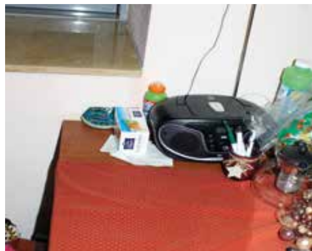
Wasserlache auf der Tischdecke: Die undichten Fenster im Wohnheim Erenkamp bereiten vielen BewohnerInnen regelmäßige Sorgen.
